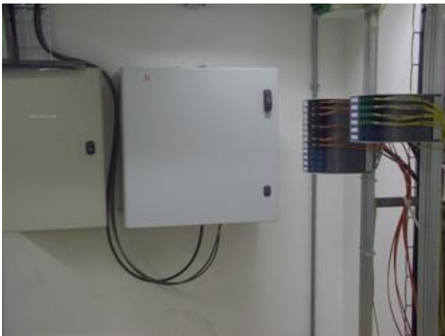
Photo de l'armoire (située dans le local technique)
