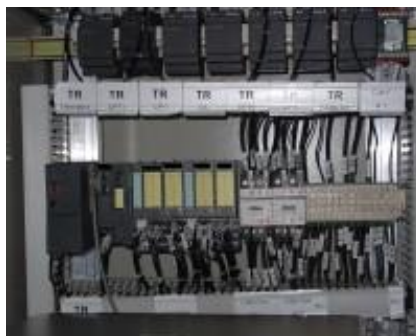
Autómatas situados en el armario DOF1-Sol
