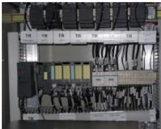
Autómatas situados en el armario DOF1-Sol
